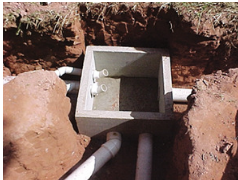
Figura 1 – Caixa de inspeção. Disponível em http://piniweb.pini.com.br/construcao/noticias/como-executar-caixas-de-inspecao-80301-1.aspx
