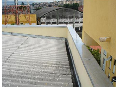
Figura 1 - Calha instalada. Disponível em http://jwzinco.com.br/home.htm
