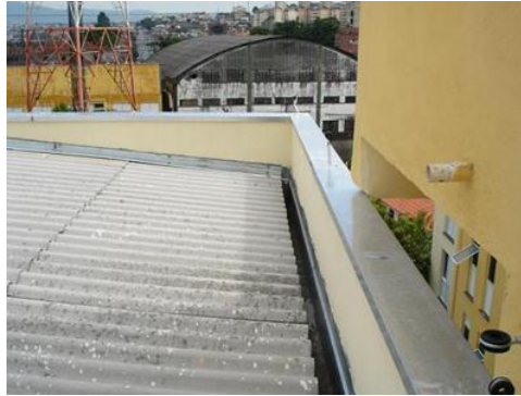
Figura 1 – Calha instalada. Disponível em http://jwzinco.com.br/home.htm
