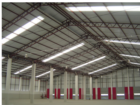
Figura 1 – Cobertura com telha metálica termoacústica. Disponível em http://www.aecweb.com.br/cont/m/rev/linha-telhaco-design-e-eficiencia-termoacustica-em-varios-nucleos-de-isolamento_7178_0_1
