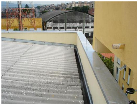
Figura 1 – Calha instalada. Disponível em http://jwzinco.com.br/home.htm
