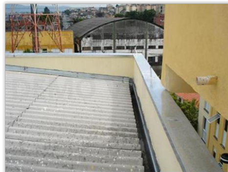
Figura 1 - Calha instalada. Disponível em http://jwzinco.com.br/home.htm
