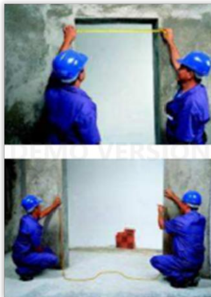
Figura 1 – Verificação de alinhamento e nível para assentamento de contramarcos. Disponível em http://professor.ucg.br/
